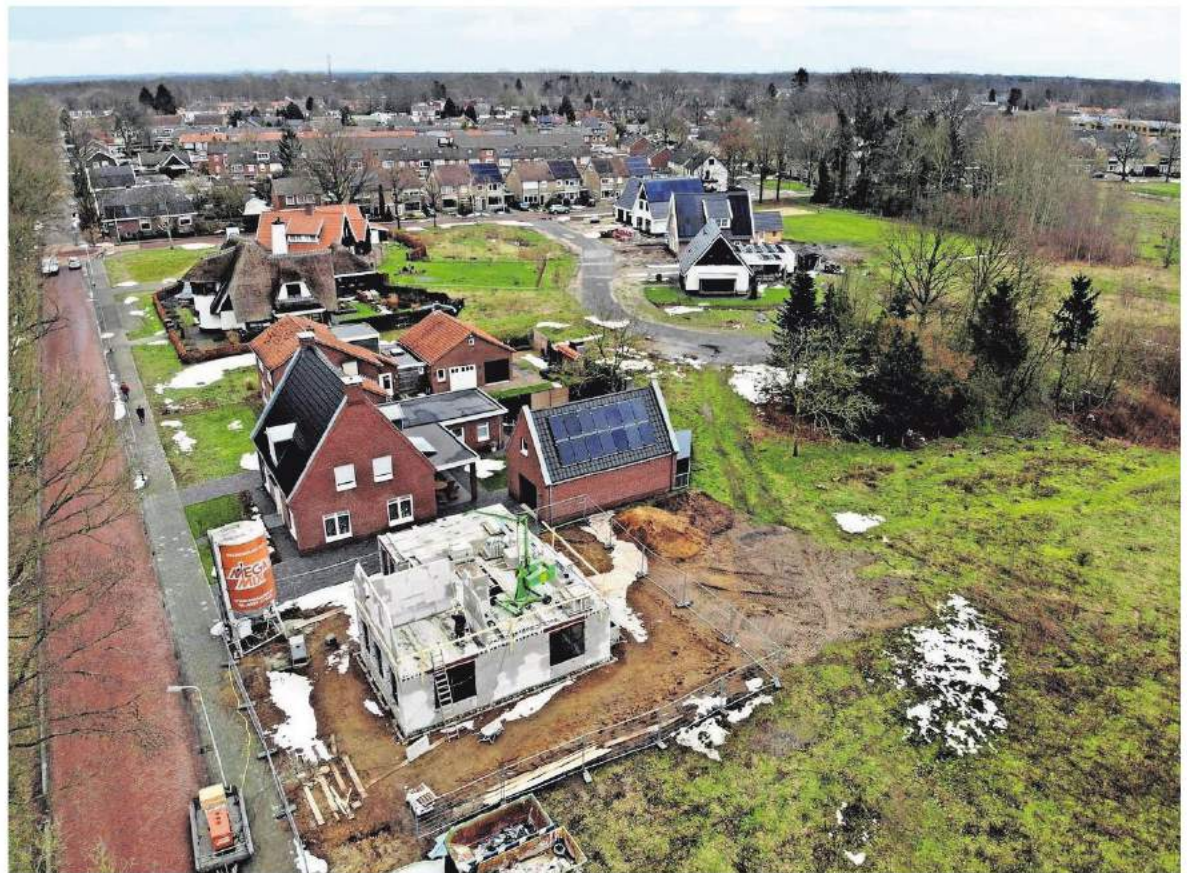
▲ Het bouwrijp maken, inclusief de aanleg van wegen, in het resterende deel van niet nieuwe wijkje De Geurmeij vergt naar verwachting een half jaar. FOTO CARLO TER ELLEN
